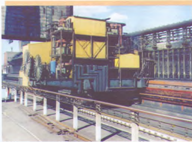
Коксовая батарея 9-бис – в строю. Идет сверхплановый кокс.
